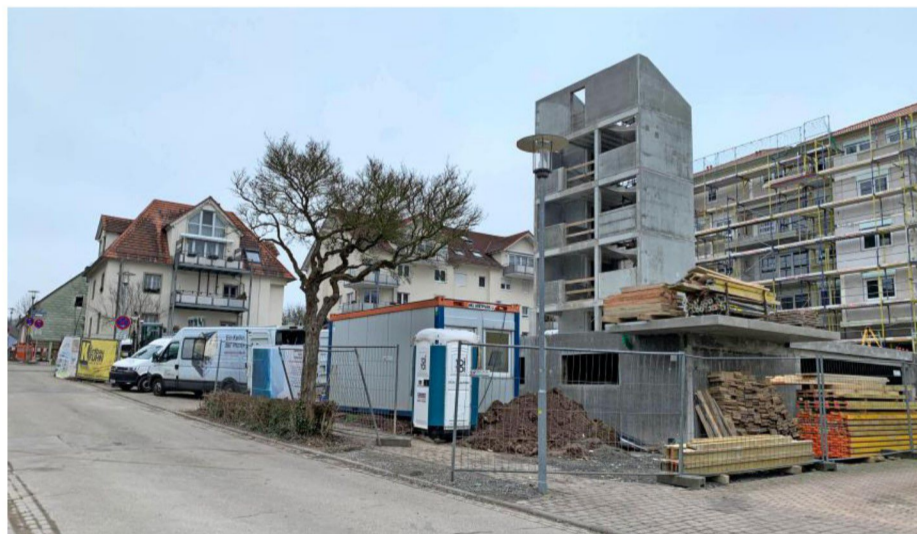
Tiefgarage, Keller, Treppenhaus und Fahrstuhlschacht müssen aus Beton sein. Alles andere wäre wirtschaftlich nicht darstellbar, sagt Planer Steffen Kolb.
